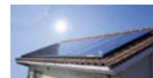
太陽光発電システム
