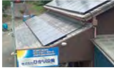
▲別棟に設置された太陽光発電装置
