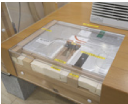
▲床暖房の設備の仕組みをスケルトンの床で確認できるブース。床の下を通したパイプにお湯が流れる様子を見ることが可能です
